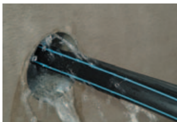
Wassereintritt an einer ...
